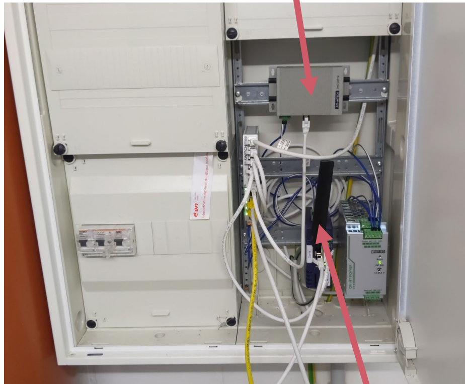
LTE Router für Kommunikation
