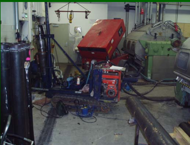
Einbau einer Stahlebene Fa. Ernstmeier in Herford, verschiedene Bauabschnitte, 159mm und 219mm bis 11m
